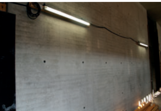
Fast alle Innenwände Sichtbeton SB4 in hellgrauem, leicht ins Beige zielenden Farbton. Einheitliche Farbgebung hatte höchste Priorität.
